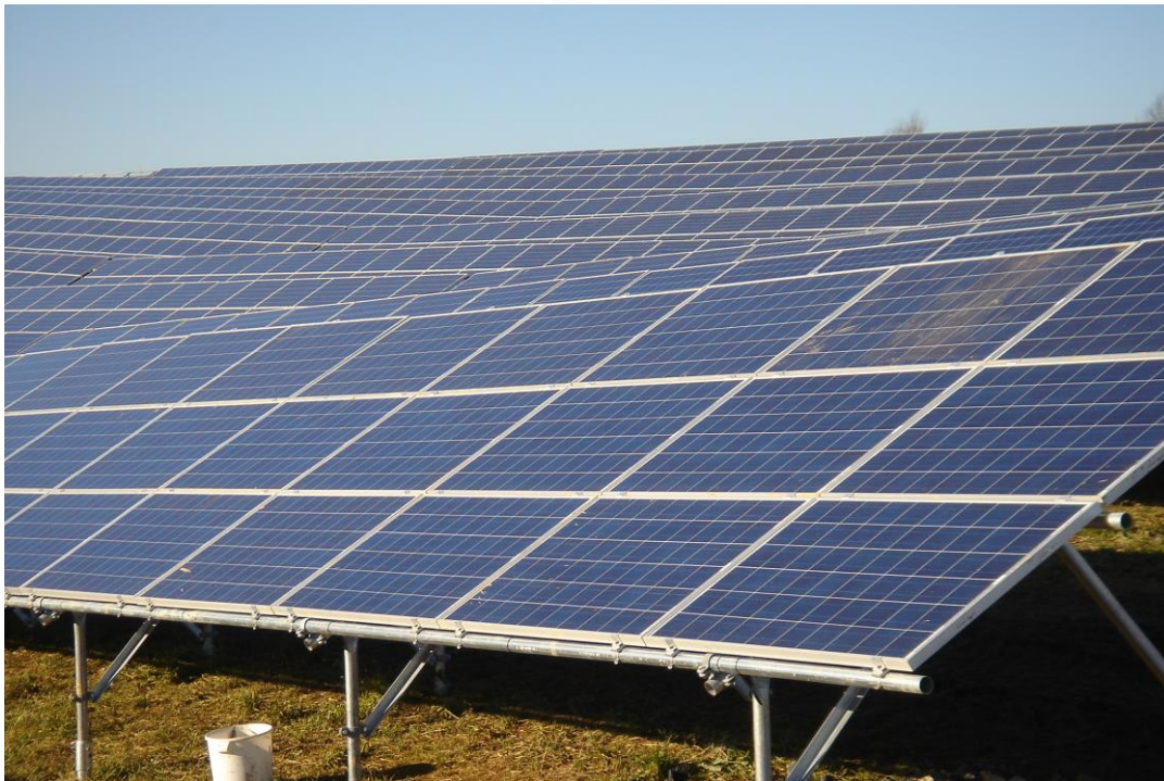
Abb. 4: Aufstellungsprinzip der Solarmodule
