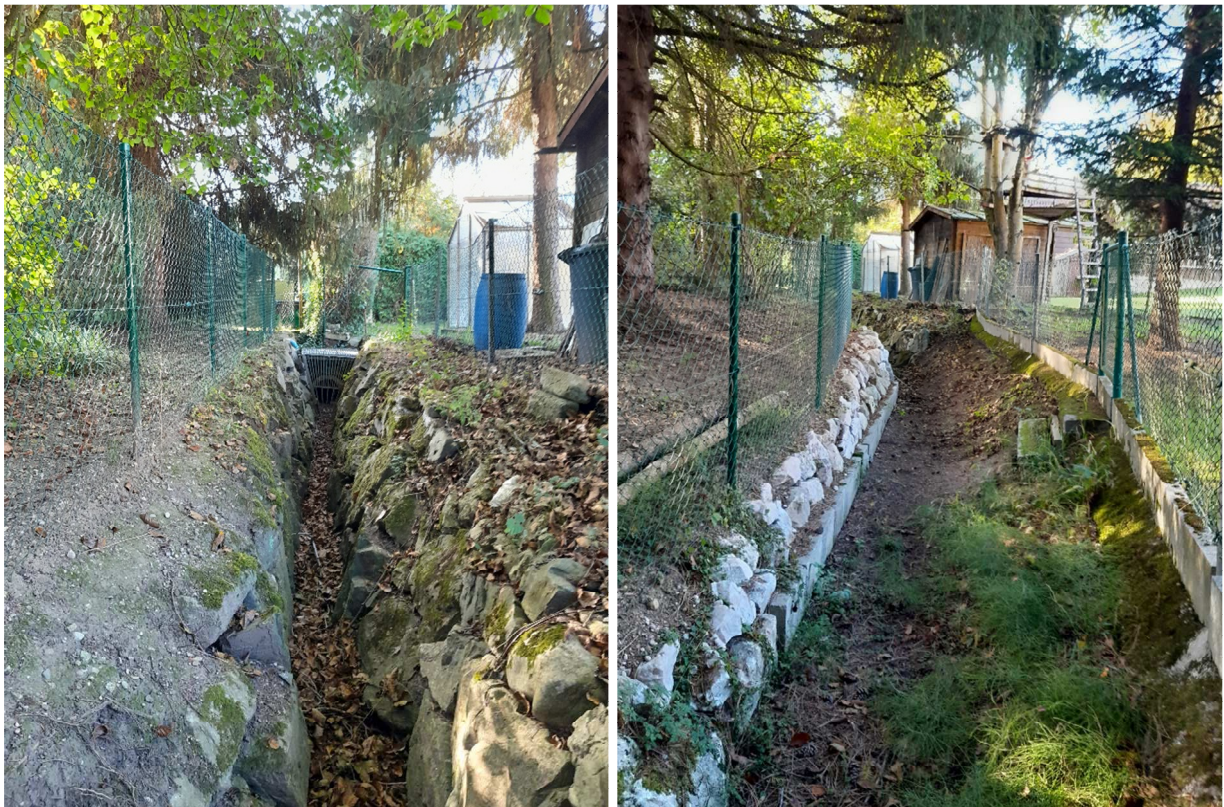
Abb. 4 links: Blick auf den Beginn der Verrohrung im Süden des UGs, rechts: teilverbauter Abschnitt des Grabens
